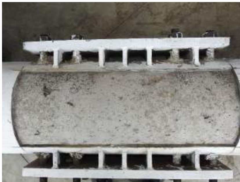
Figura 7-1.- Grietas a tensión en ventana de chequeo para Columna PTE D323.9x10-W18x35-1-2
