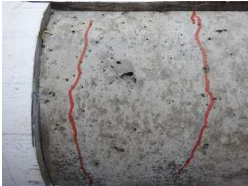
Figura 7-2.- Línea de fisuras en dirección de pernos para PTE D323.9x10-W18x35-1-2
