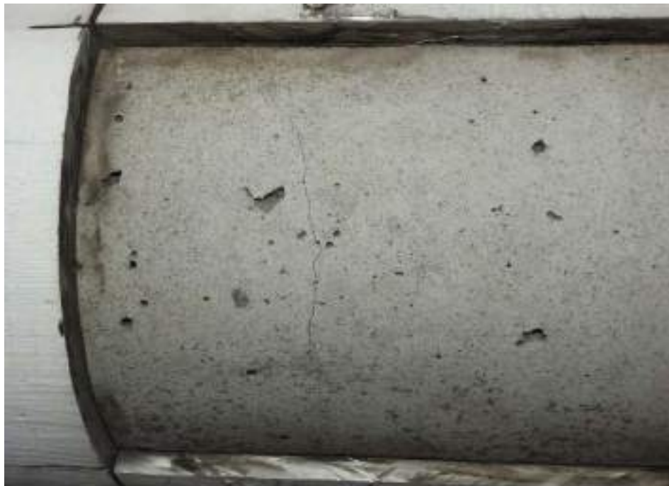
Figura 7.1-2.- Detalle de fisura en línea de perno
