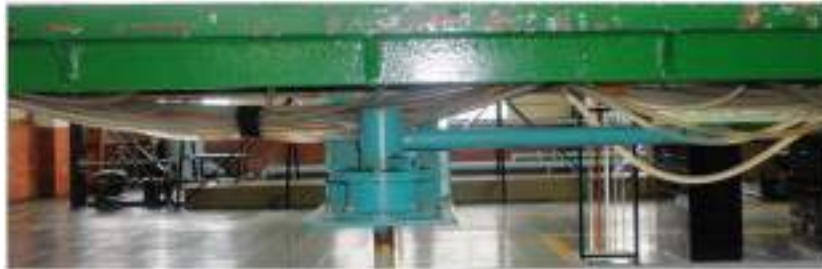
Figura 2.1-6: Palanca que direcciona el flujo al tanque de almacenamiento.
