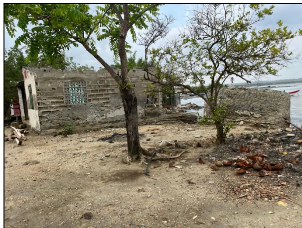
Figura 12. Viviendas destruidas por la erosión costera
