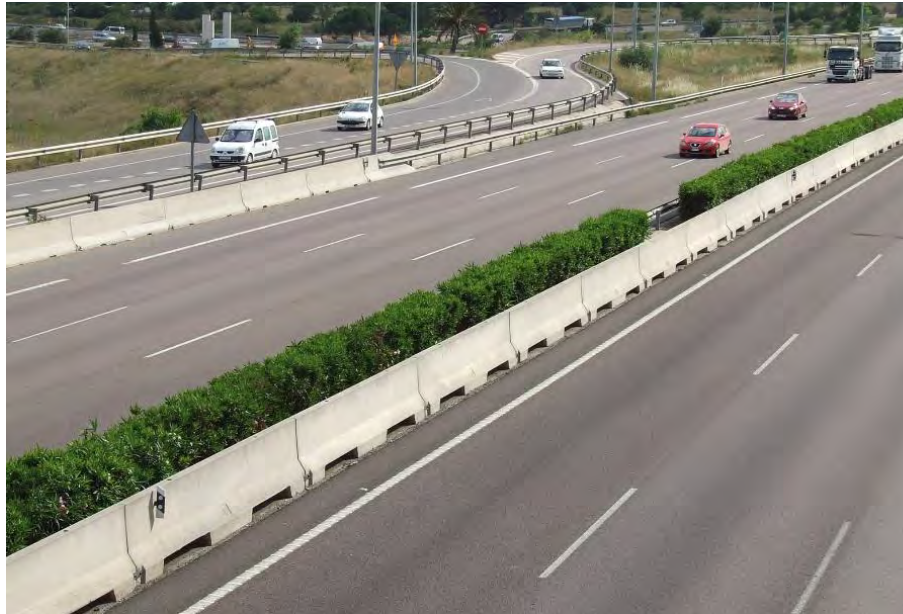
Figura 77. Barrera rígida de perfil de concreto
