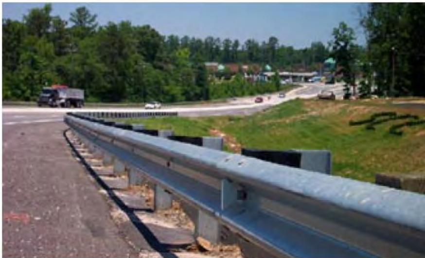
Figura 56. Defensa metálica típica
