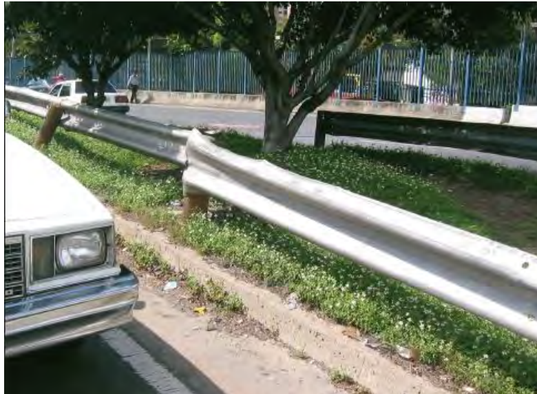
Figura 67. Defensa instalada sobre el separador central
