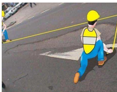
Figura 4. Descascaramiento-pérdida de la capa de rodadura (peladuras) 16
