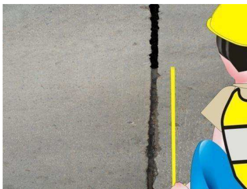
Figura 15. Deficiencia del sellado 28
