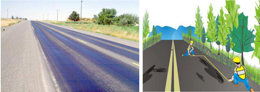
Figura 6. Exudación del asfalto (sangrado) 18
