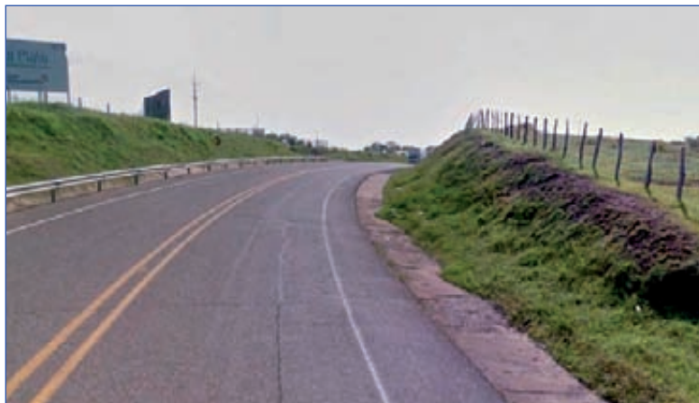
Foto 4. Curva con problemas de visibilidad – K6+600.
