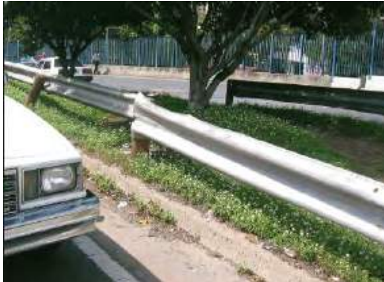
Figura 67. Defensa instalada sobre el separador central
