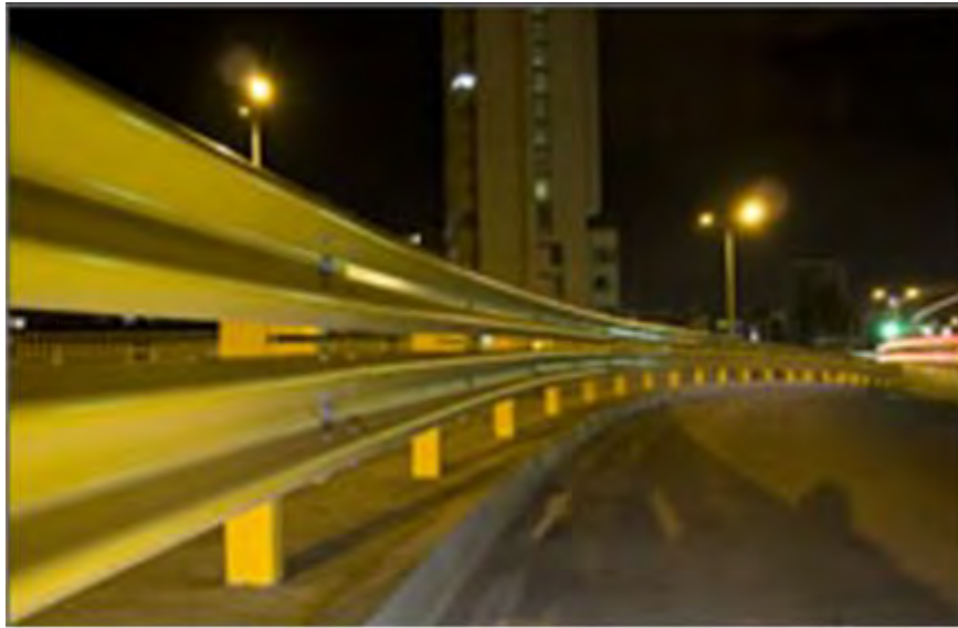
Figura 54. Defensa metálica con doble perfil W
