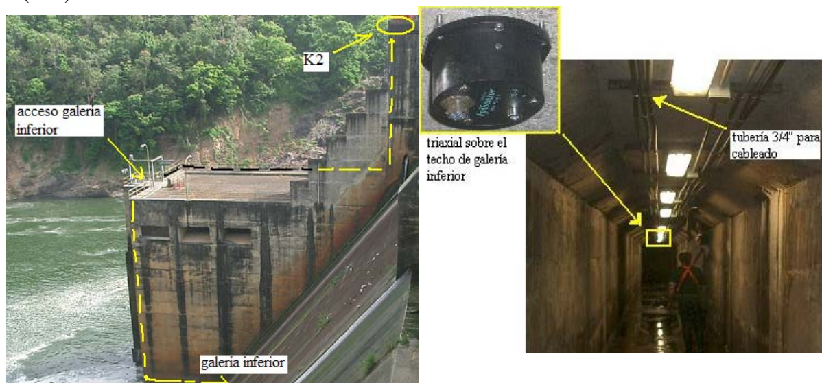
Figura 11-9: Instalación y ubicación del sensor triaxial en la galería inferior
