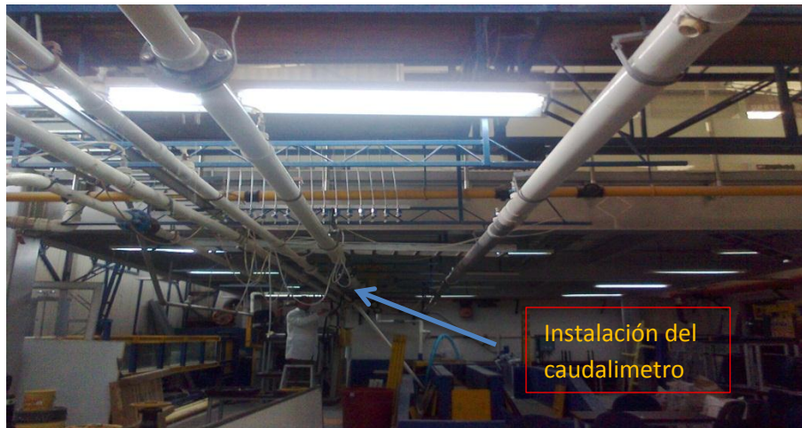
Figura 3-12. Fotografía del montaje del circuito de tuberías de donde se extrae el agua para el ensayo.
