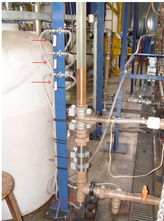
Figura 71. Dispositivo para geração de padrões instalado na linha vertical (seta inferior) e válvulas para seleção manual do injetor de ar (as tres setas em vermelho).
