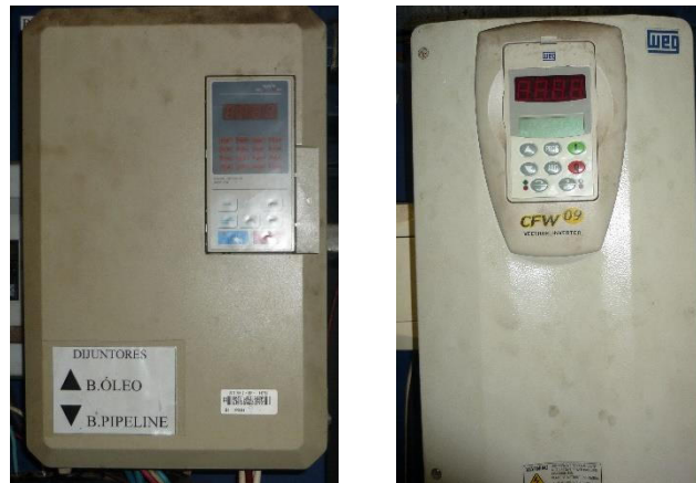
Figura 50. Inversores de Frequência.
