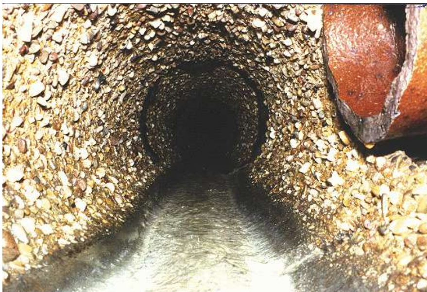
Figura 4-6. Corrosión biogénica de una tubería de concreto en un sistema de alcantarillado residual domestico en Alemania, 15 años de servicio. (Steinzeug-Keramo, 2011)
