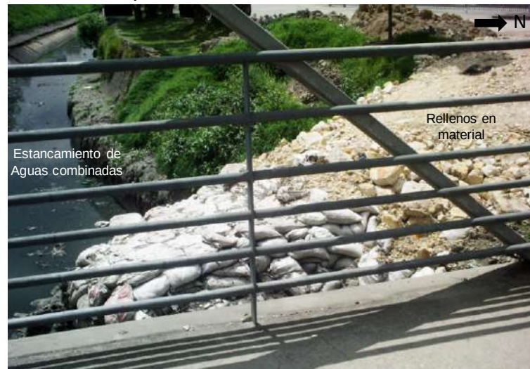
Fotografía 6-4. Soluciones provisionales al reflujo del alivio en el canal Salitre con Carrera 68. Recorrido de campo 11/02/2012.
