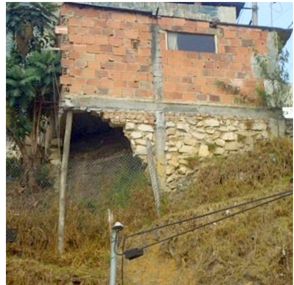
Figura 6: Condiciones estructurales de la vivienda informal. Fotografía propiedad del Ing. Luis Guillermo Aycardi
