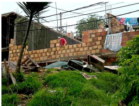
Figura 3: Condiciones estructurales de la vivienda informal. Fotografía propiedad del Ing. Luis Guillermo Aycardi
