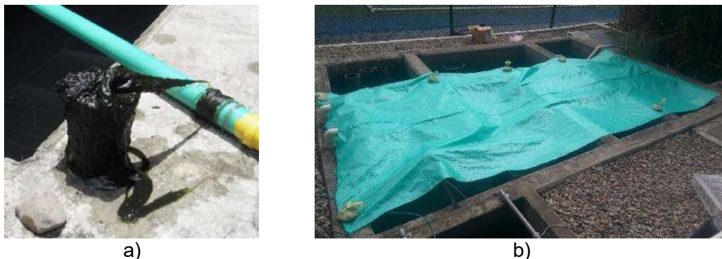
Figura 4 Crecimiento de algas en las trampas. Desarenador Oriental a) Crecimiento de algas, b) Cobertura con polisombra
