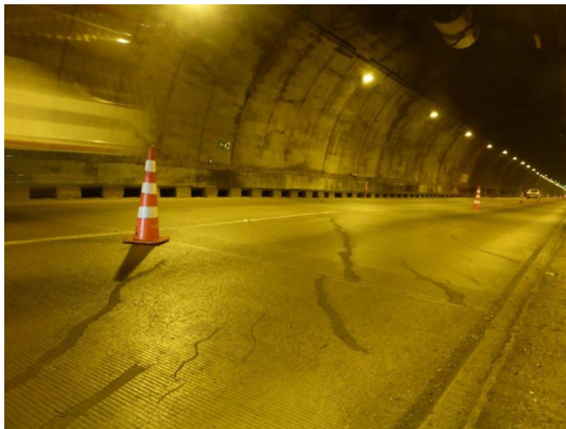
Figura 1.3: Patrón de deformaciones en el pavimento
