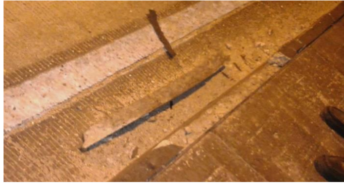
Figura 4.10: Desprendimiento de bordillo por presión
