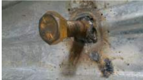
Figura 2-1: Afectaciones ocasionadas por soldadura en perfiles doblados en frío (CFS).
