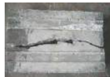
Falla del concreto
