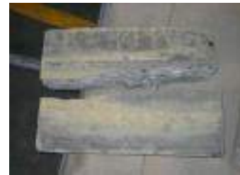
Falla del concreto
