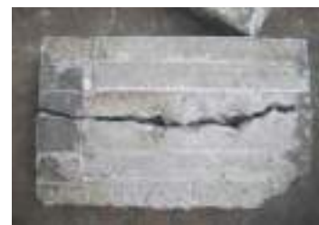
Falla del concreto
