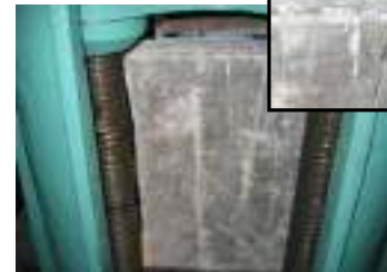
Falla del concreto
