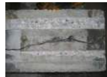
Falla del concreto
