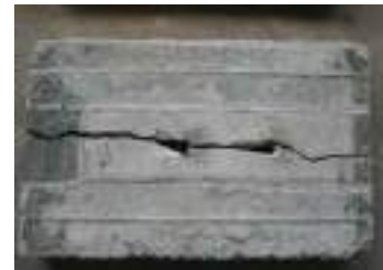
Falla del concreto
