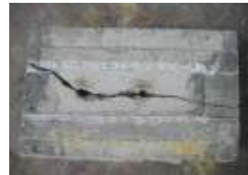
Falla del concreto
