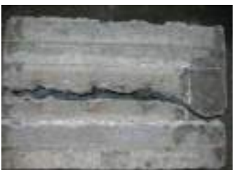
Falla del concreto
