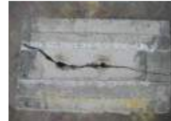
Falla del concreto
