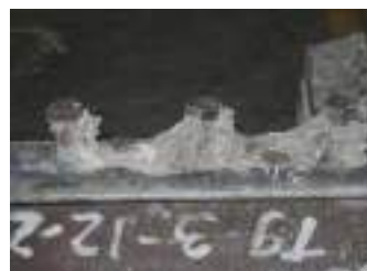
Daño de los tornillos
