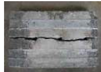
Falla del concreto
