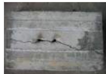
Falla del concreto
