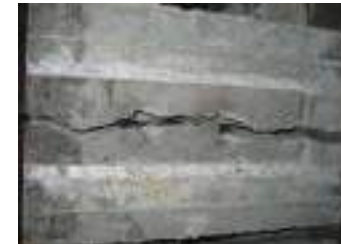
Falla del concreto
