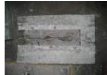
Falla del concreto
