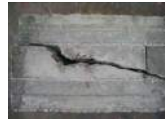
Falla del concreto
