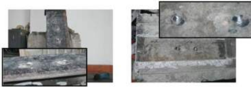
Figura 3.4. Falla de la soldadura de las probetas M4-2-8-1
