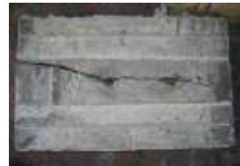
Falla del concreto
