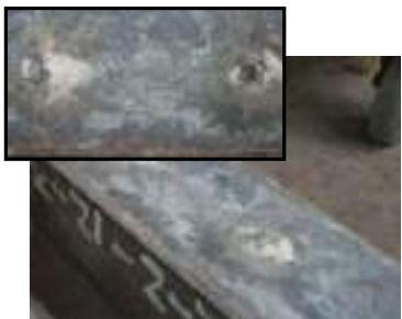
Falla de la soldadura
