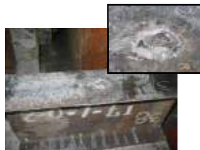
Falla de la soldadura
