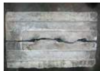
Falla del concreto
