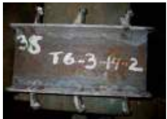
Daño de los tornillos
