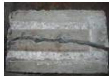
Falla del concreto
