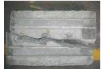
Falla placa de concreto inferior
