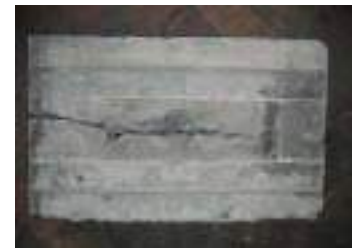
Falla del concreto
