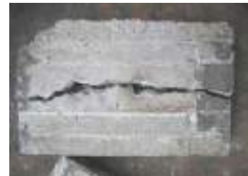
Falla del concreto
