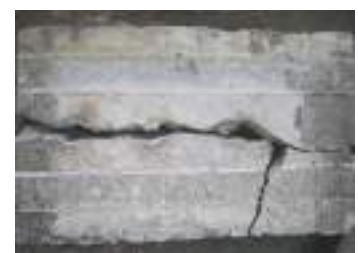
Falla del concreto
