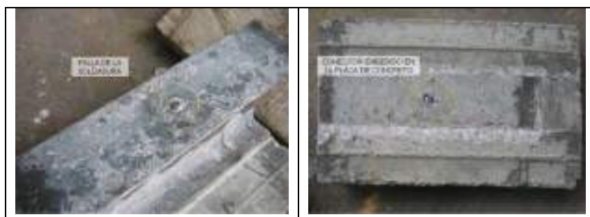
Figura 3.42. Falla de la soldadura
