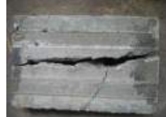
Falla del concreto
