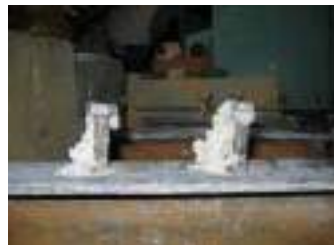
Daño de los tornillos
