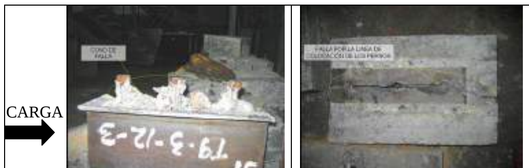
Figura 3.41. Falla del concreto.
