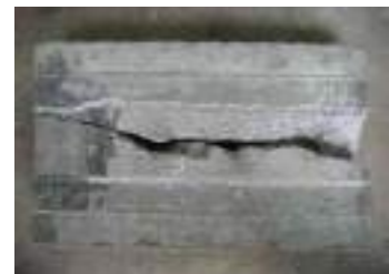
Falla del concreto
