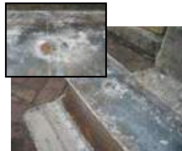
Falla de la soldadura
