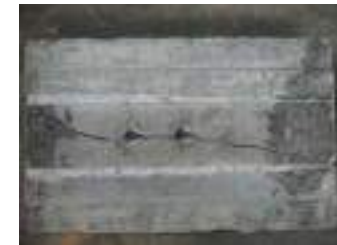
Falla del concreto
