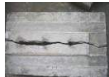
Falla del concreto
