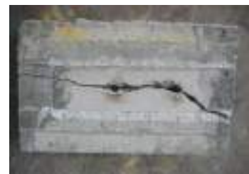
Falla del concreto
