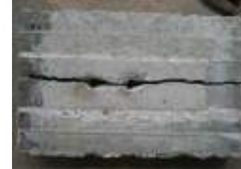
Falla del concreto
