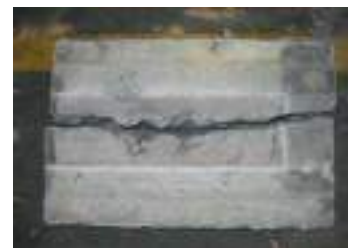
Falla del concreto
