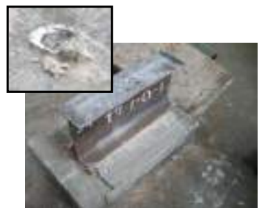
Falla de la soldadura
