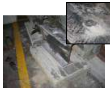
Falla de la soldadura
