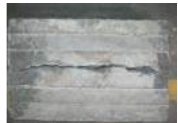
Falla placa de concreto superior
